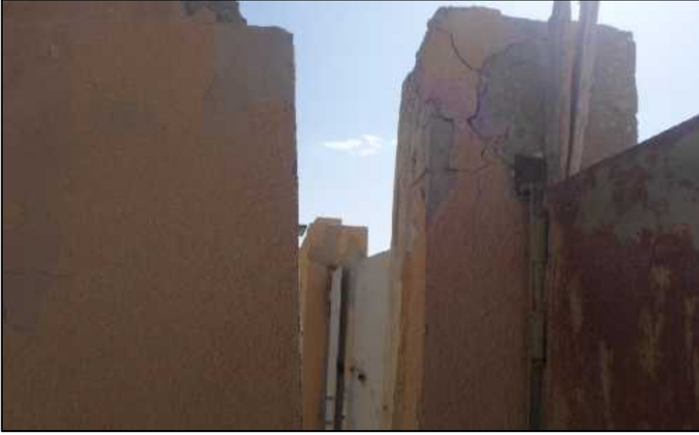
صورة (8.4) انهيار العنصر الخرساني نتيجة تأثره بالملوحة الأرضية
