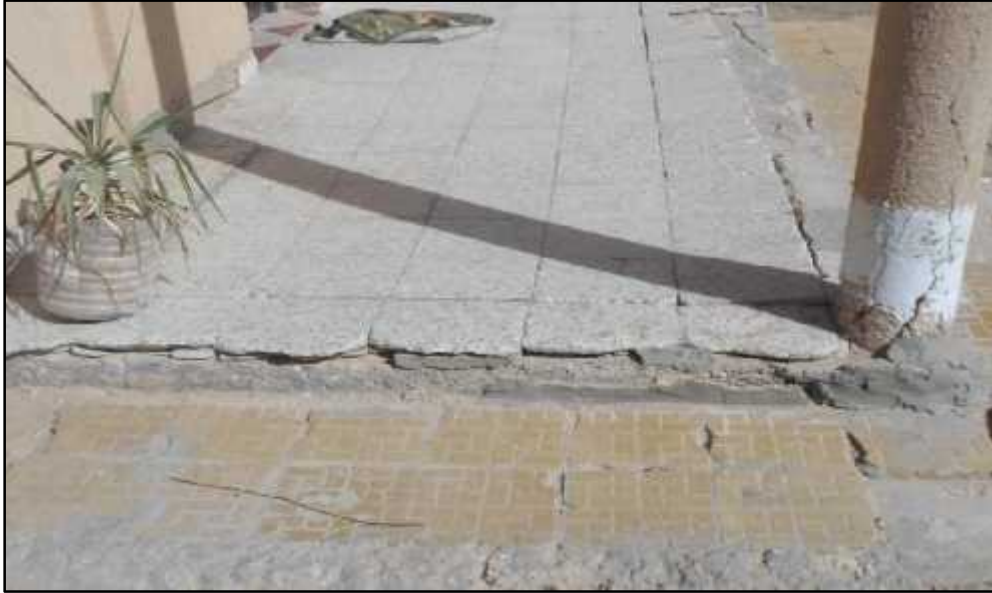
صورة (9.4) تقويض سفلي في أرضية المبنى نتيجة هبوط الطبقة السطحية للتربة
