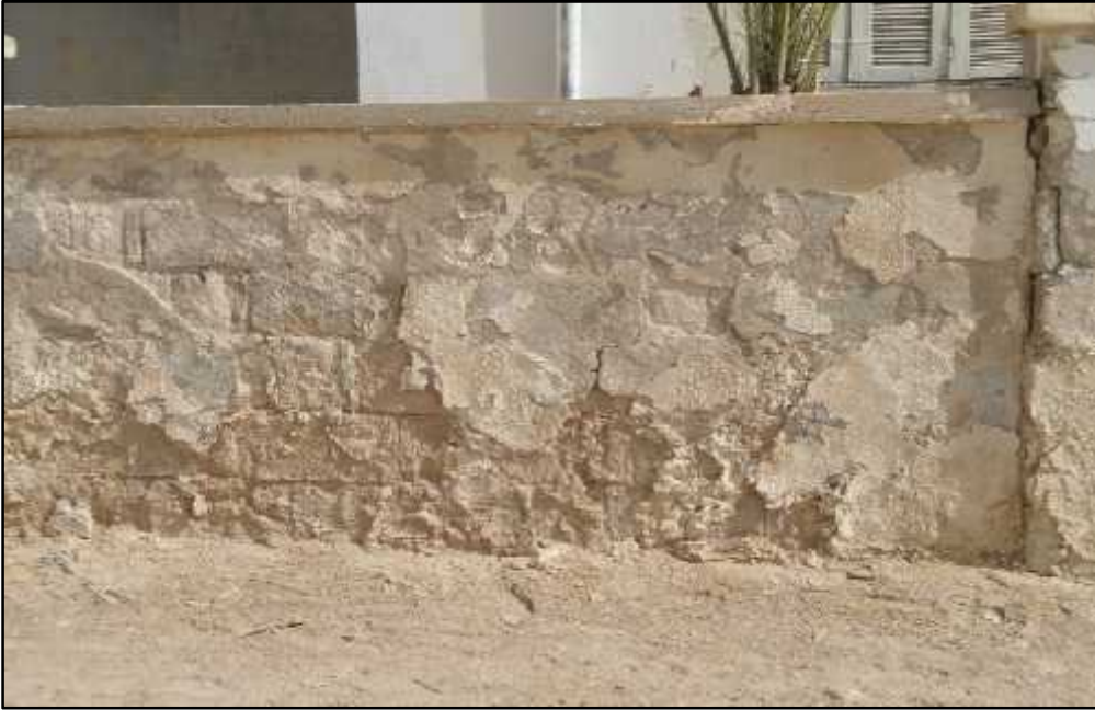
صورة (6.4) تآكل الجدار الخارجي للمبنى نتيجة لتأثره بالملوحة الأرضية
