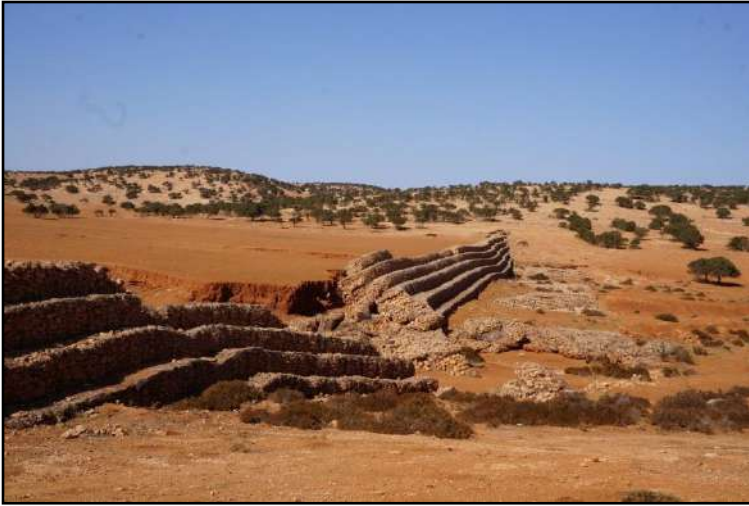
صورة (1) سد منهار (موقع المنجل).
