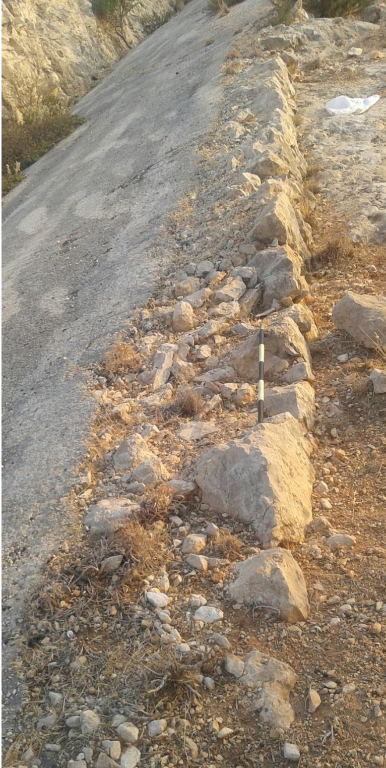
صورة رقم (34) آثار المسار القديم المغطى بالإسفلت العائد للاحتلال الإيطالي مدعوم بساند من الحجارة من الجهة المطلة على الوادي (عقبة سوسة)
